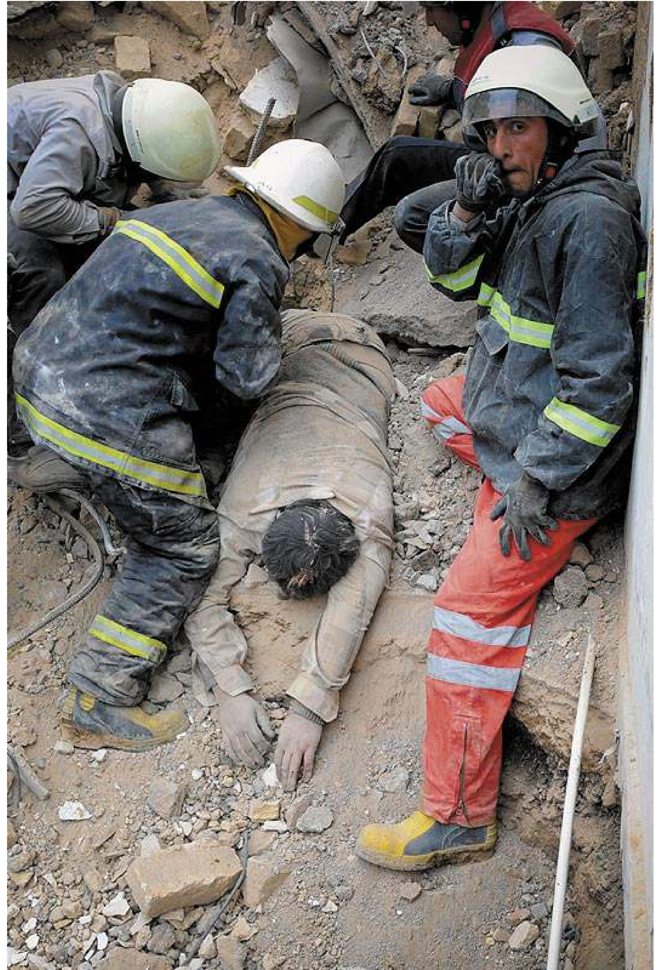
تخریب غیراصولی یک ساختمان قدیمی در یکی از محلات مشهد منجر به فوت یکی از کارگران شد/ عکس: سید حمید هاشمی
